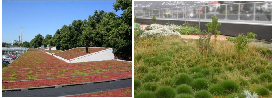
Figur 13. Gröna tak med olika karaktär och fördröjningsförmåga.
